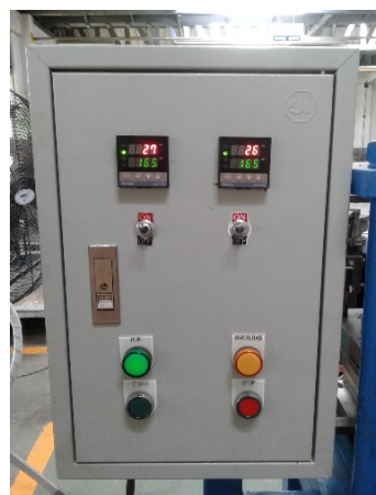
รูปที่ 3 ลักษณะตู้ Electrical Control ควบคุมการทำงาน
